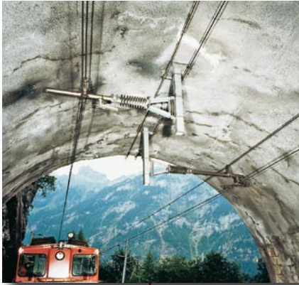
Erste Installation für die Bahn, 1979
