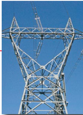
500-kN-Abspannkette für 420 kV, 2004
