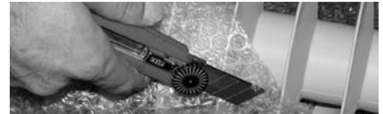
Abb. 31: Vermeidung von Schnittverletzungen des Isoliermantels
